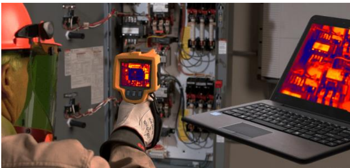
Рисунок 20. Пример проведения тепловизионного контроля электрошкафа
